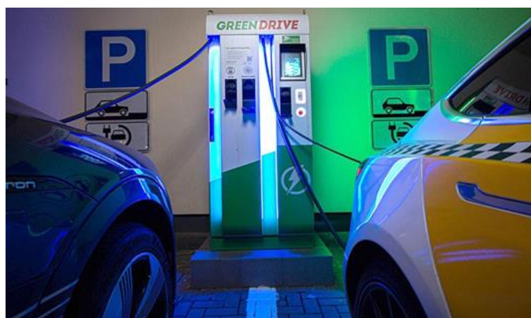
Рисунок 2 – Зарядные станции для электромобилей
